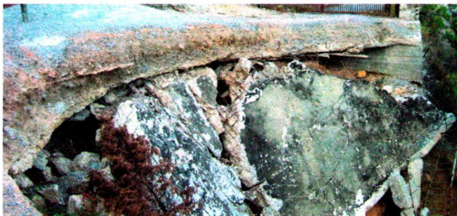
Рис. 167. Оползень на горном склоне разрушил дорогу
